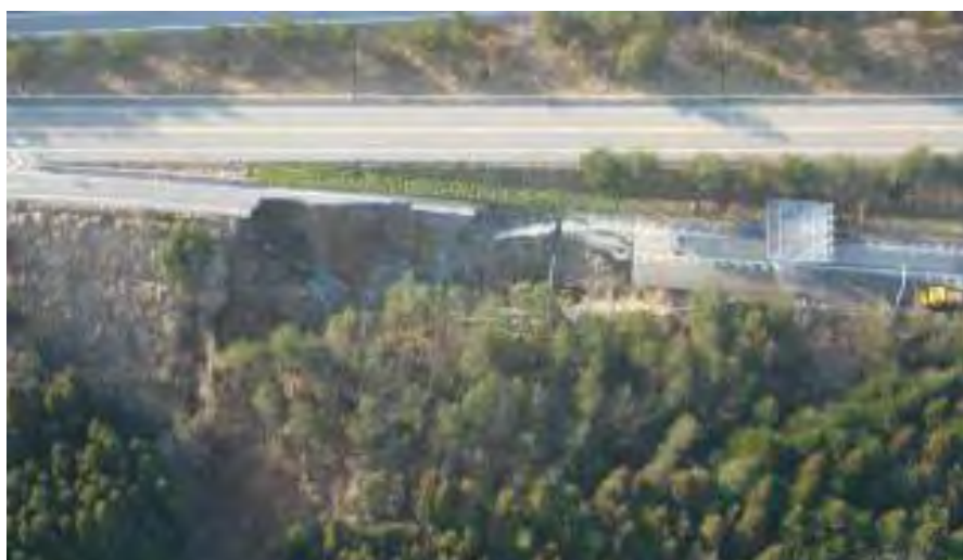
写真-5.1 崩壊状況
